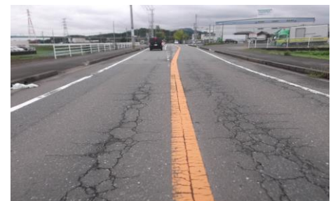
老朽化した道路舗装の打ち替え予定箇所
