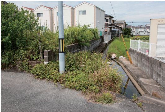
M. <住宅地>ブロック塀/防護柵 令和3年(2021)8月16日撮影
