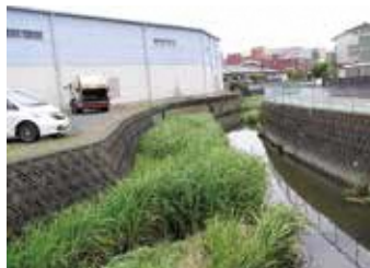
須川に堆積している土砂と(こも)類
