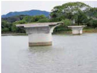
復旧を待つ水鳥橋
