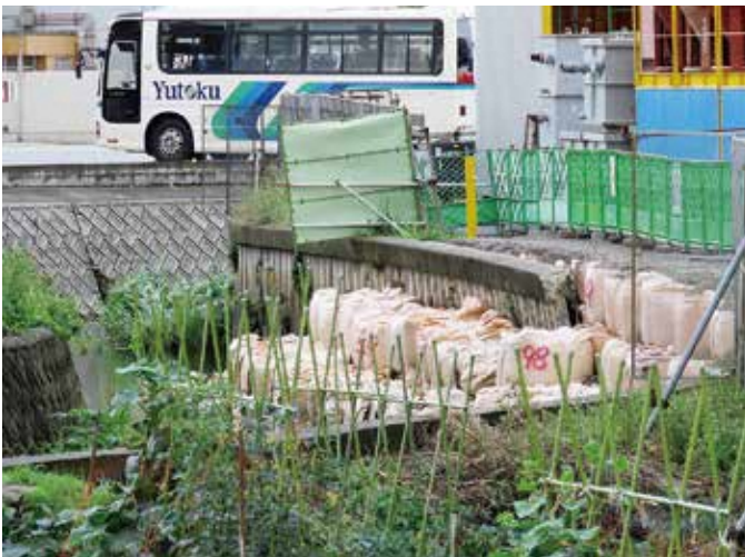
倒壊した南里水路
