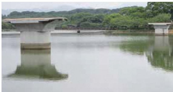
橋脚をさらしたままの水鳥橋
