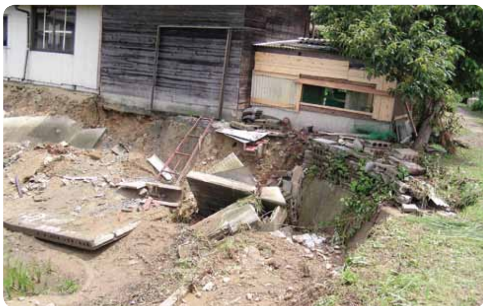
平成21年水害被害(雨水地区)
